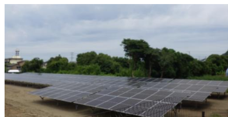
ペリエ太陽光発電所館山那古
