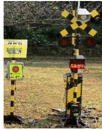
④踏切機器
